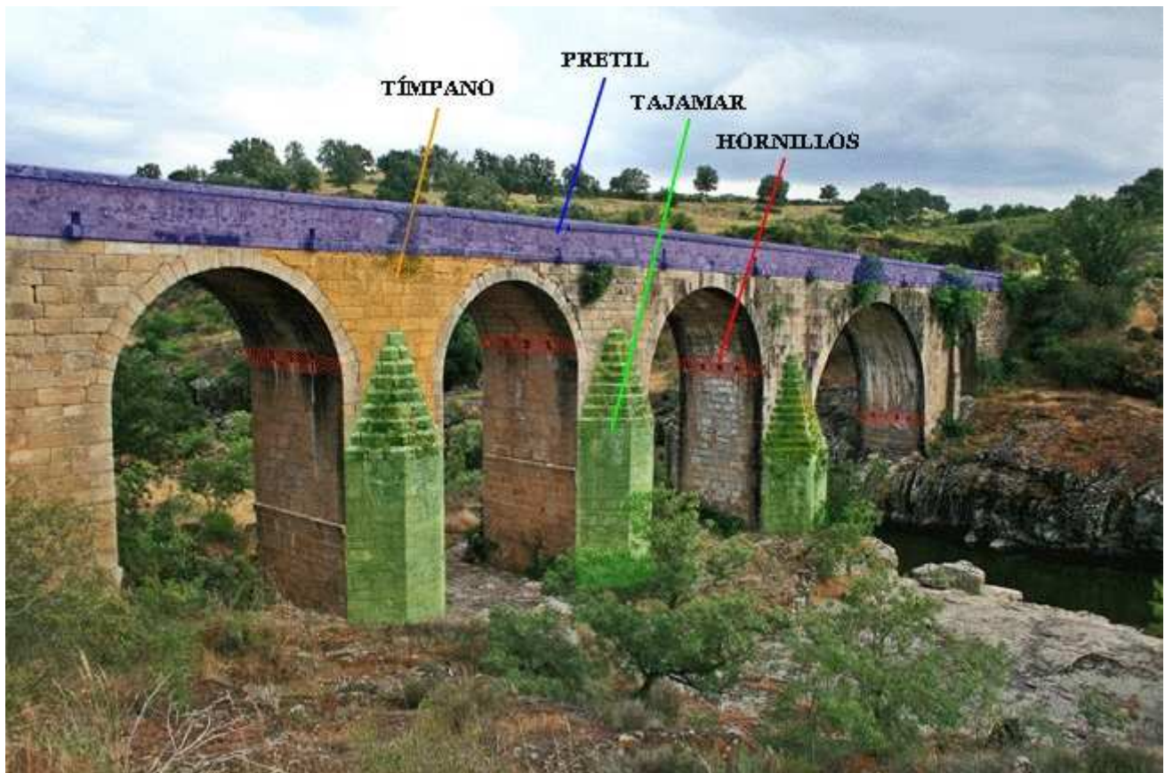
Partes típicas de un puente de piedra, en este caso en el puente de Cerralbo
